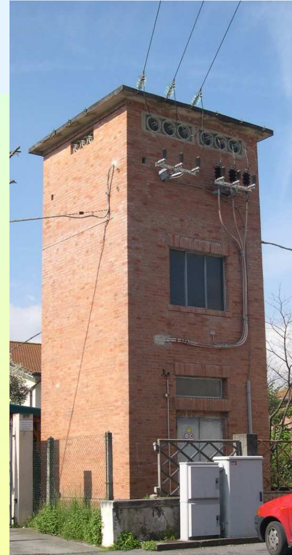
Cabina MT/BT “a torretta” standard del passato
